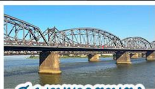
สะพานขาดตานตง
